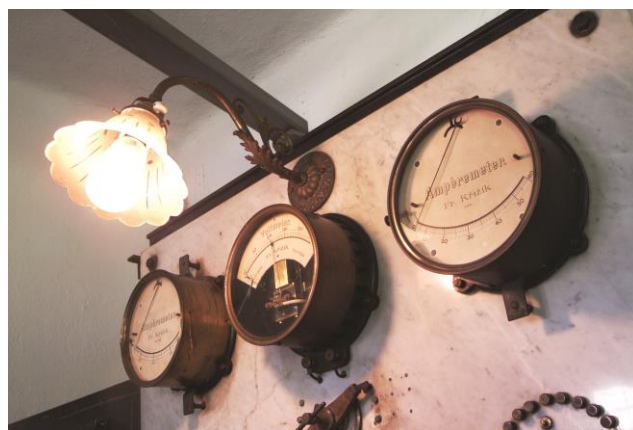
Obrázek 14: Rozvodná mramorová deska v roce 2006 dodaná Ing. Františkem Křížikem do Křemežské elektrárny v roce 1906.
