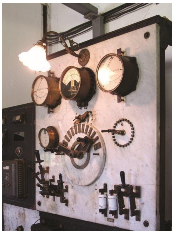
Obrázek 13: Rozvodná mramorová deska v roce 2006 dodaná Ing. Františkem Křížikem do Křemežské elektrárny v roce 1906.
